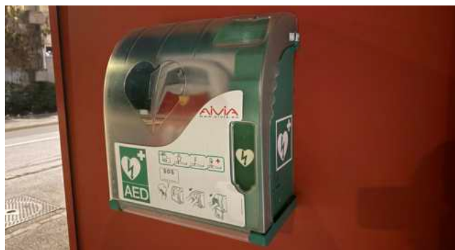
// Les défibrillateurs sont placés dans un boîtier extérieur chauffé pour assurer le bon fonctionnement de ses batteries. Une alarme se déclenche automatiquement à l'ouverture du dispositif.
